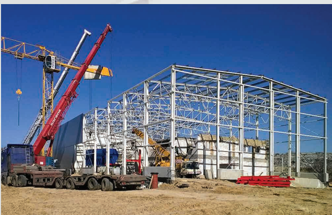
Waste sorting facility in Regionalny Zakład Zagospodarowania Odpadów in Dębowiec, Poland
