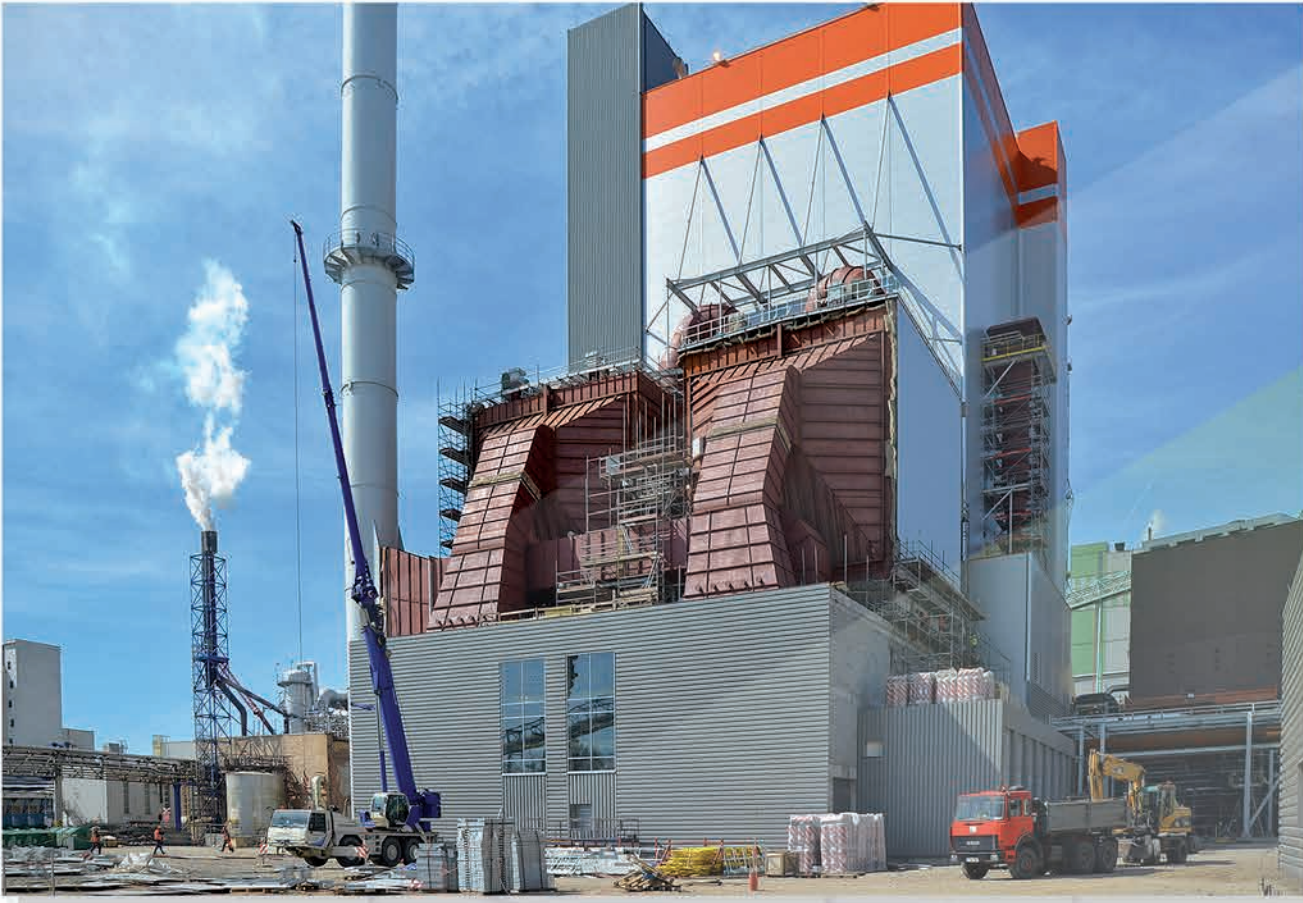
Montage eines Rückgewinnungskessels (Recovery Boiler) 2 300 tds/d (Tonnen Trockensubstanz pro Tag) und von zwei Elektrofiltern in der Papierfabrik Mondi Świecie, Polen
