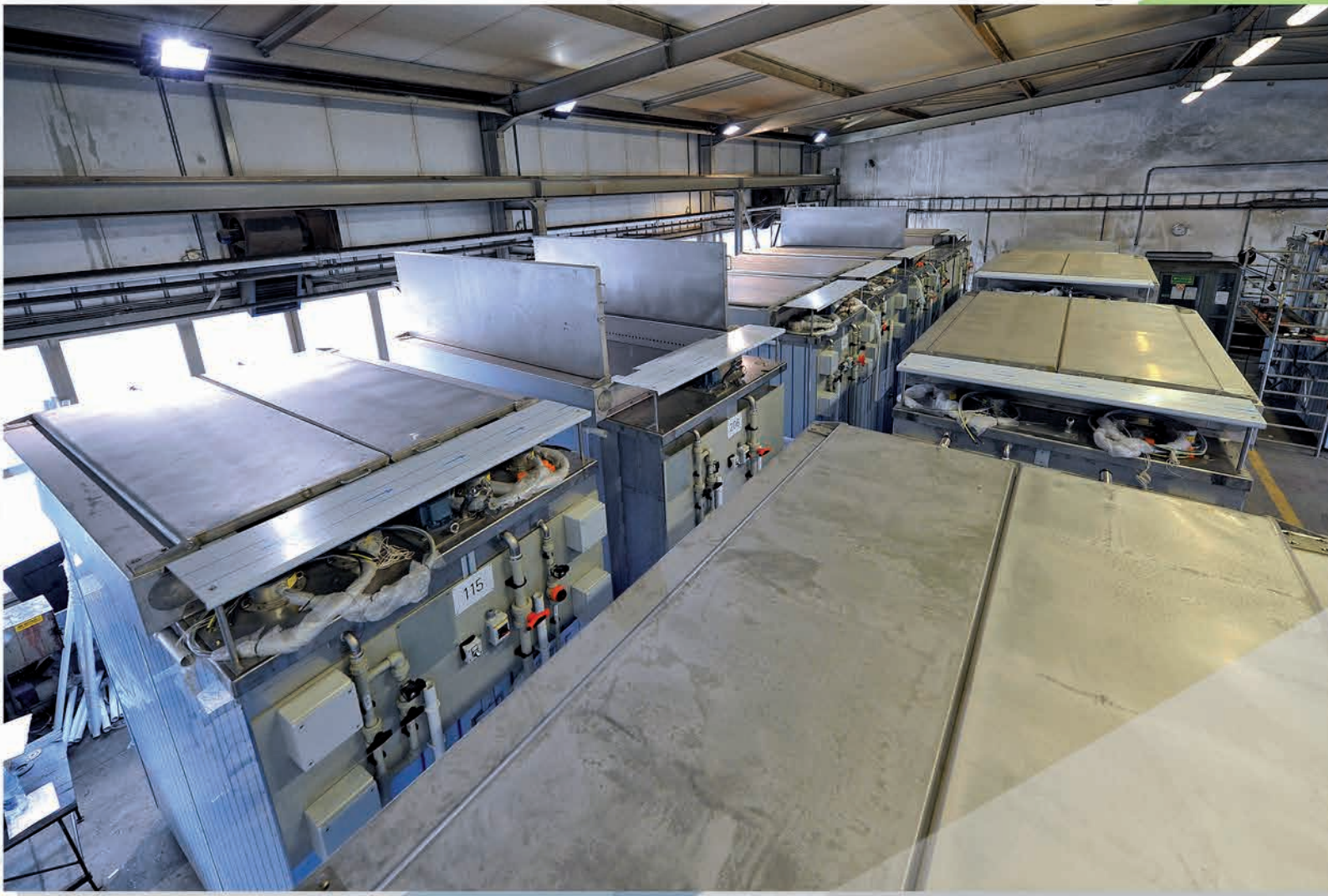
Fertigung von galvanischen Behältern für General Electric in den Vereinigten Arabischen Emiraten
